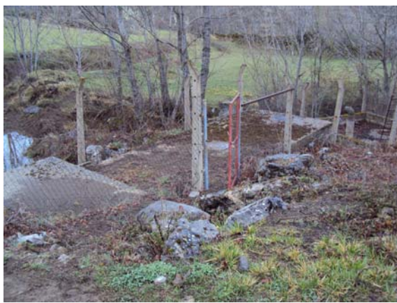
FOTO 1.- Depósito de agua
