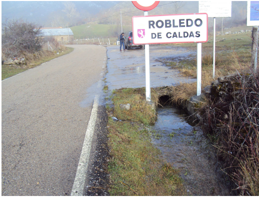
FOTO 1.- ROBLEDO. RECOGIDA DE PLUVIALES
